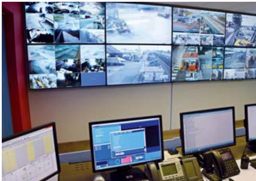
Centro de Coordinación de Seguridad de Nissan.
