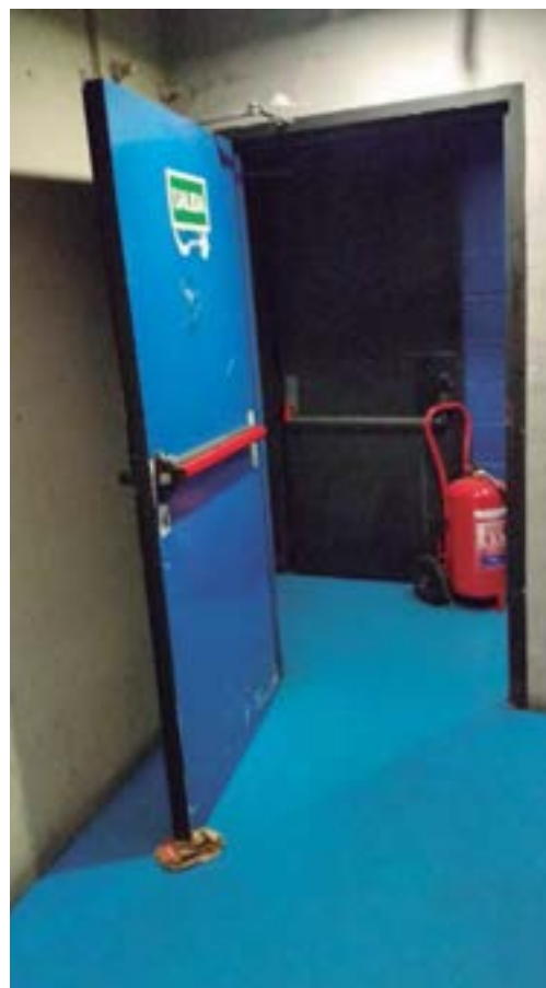
Malas prácticas, puerta cortafuegos y extintor.
