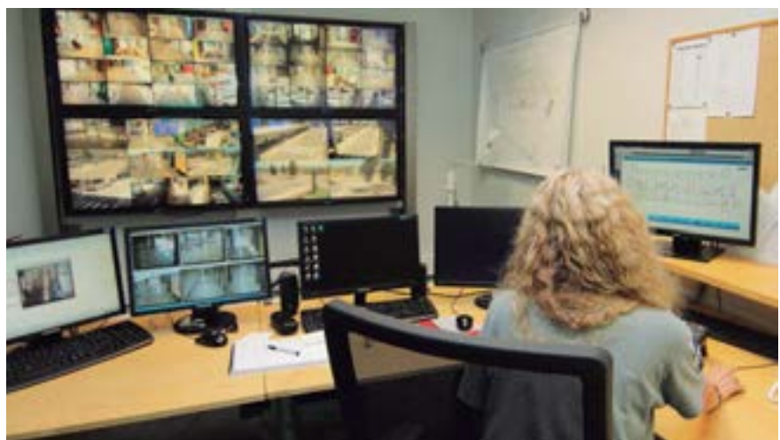
Centro de Control Seguridad.
